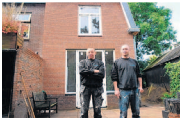
Jan van Os van het gelijknamige Van Os Timmerwerken en collega Louis Bernds zijn druk bezig met hun specialiteit: de renovatie van een echt klassieke jaren 30 woning.
